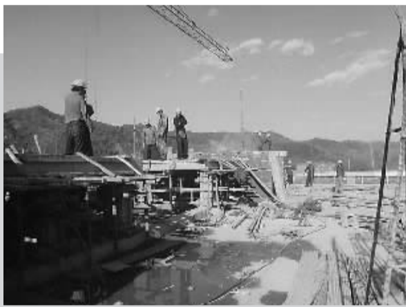
营子区汪家庄镇紧紧抓住城镇面貌三年大变样的历史机遇,从改善居民居住条件入手,加快推进汪家庄的城市化建设进程。图为该镇1#商住楼封顶施工现场。
