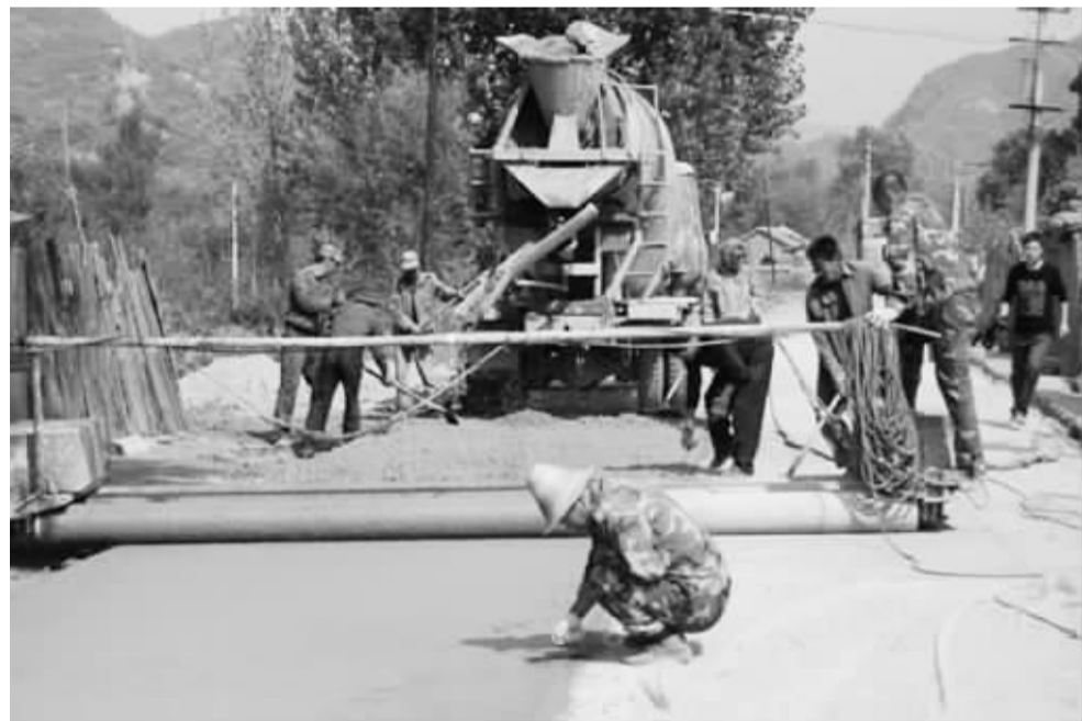
近日,营子区乡道汪家庄——西帽子山建设工程已经完成近千米的混凝土路面铺设,“十一”国庆期间,交通工作人员放弃长假休息时间,依然坚守在工程施工现场,保证在最短的时间内完成最高的工程质量。该工程预计年内竣工通车。 杨丽银 摄
